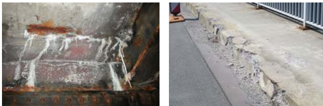
Offensichtliche Schäden am alten Brückenüberbau
